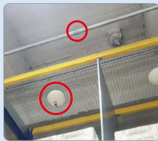
■ 각 격리공간 소화설비 설치
