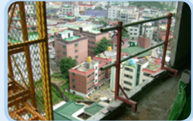
리프트 측면 안전난간 길이 부족
