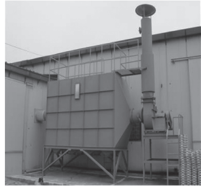
활성탄 흡착탑 설치 예
