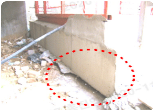
기초부 바닥 벌어짐 (기초부 침하)
