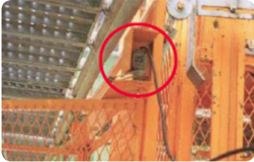
1층 방호울 연동장치
