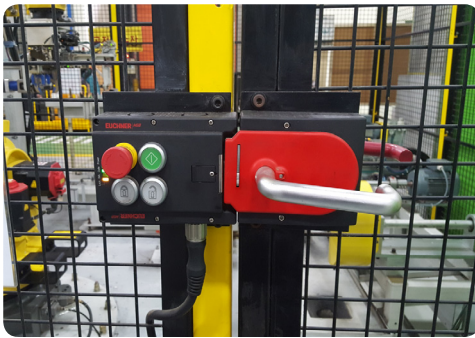
출입문 연동장치 및 잠금장치
