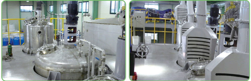
국소배기장치 설치로 유해물질로 인한건강장해 예방
