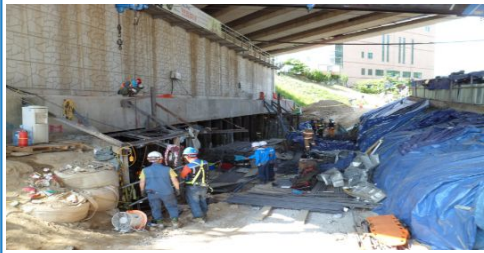
복선전철 교량 하부보강 중 LPG폭발 (‘16.6.1 사망 4, 부상 10)
