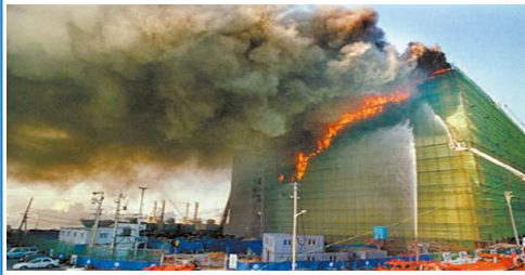
부산 냉동창고 신축공사 화재 (‘98.10.29 사망 27, 부상 16)
