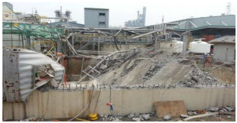
폐수 환경설비 구축공사 중 폭발 (‘15.7.3 사망 6, 부상 1)
