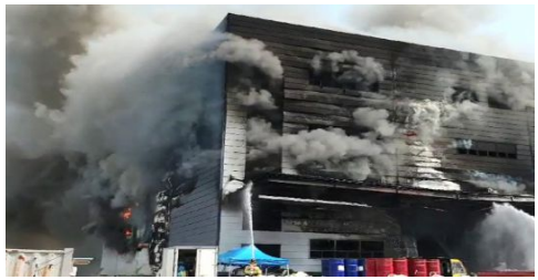
이천 물류센터 신축공사 중 화재 (‘20.4.29 사망 38, 부상 10)
