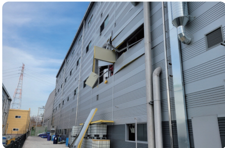
그림 2 폭발의 영향으로 파손된 건물 외벽
