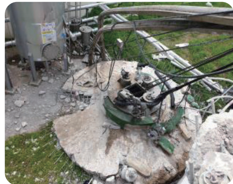
그림 2 소화조 상부가 떨어진 상태
