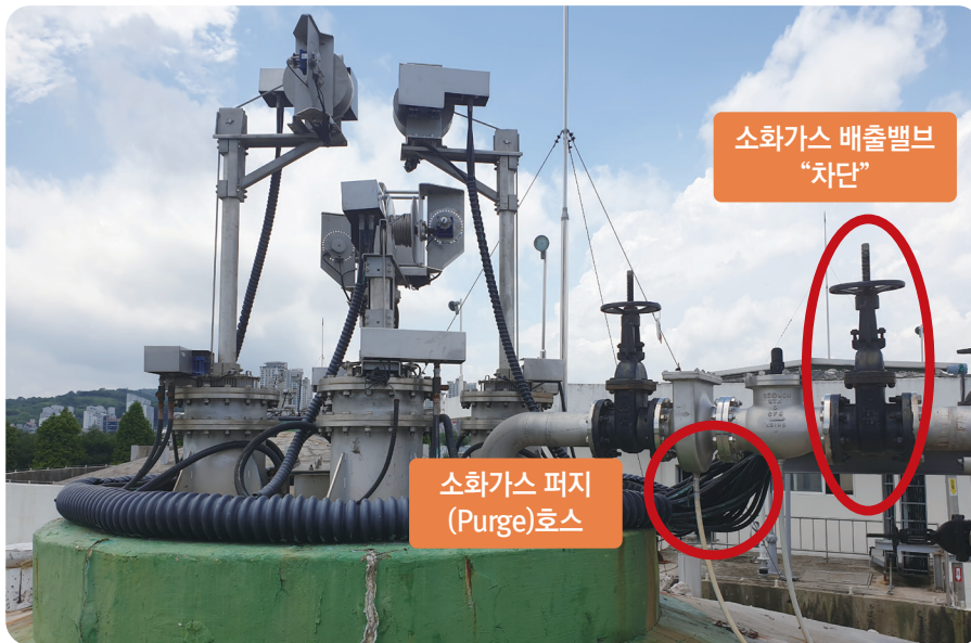
그림 11 소화조 상부 소화가스 배출배관 및 배출호스(질소 퍼지 미실시)
