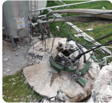
그림 2 소화조 상부가 떨어진 상태
