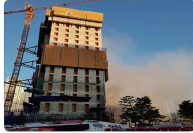
광교○○신축공사 중 화재 ('17.12.25. 사망 1, 부상 13)
