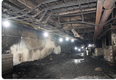
주상복합 신축공사 중 화재 ('18.6.26. 사망 3, 부상 37)
