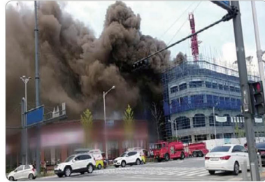
근린생활시설 신축공사 화재 ('16.9.10. 사망 4, 부상 2)
