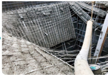
데크플레이트 붕괴 후
