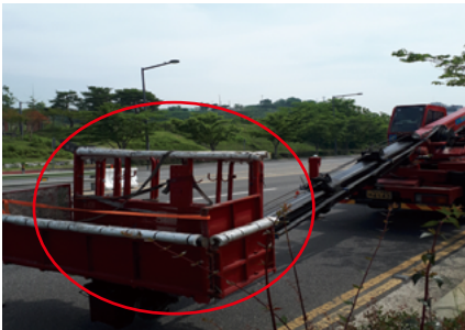
고소작업대 안전난간 미설치
