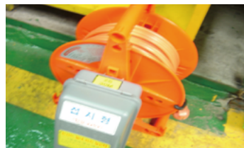
충전부 방호조치·누전차단기 설치
