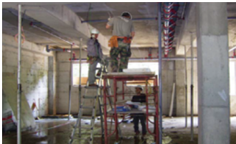
상부작업대 안전난간 미설치
