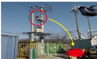
가로등·신호등 작업발판 미설치
