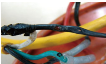
전선 심선노출·누전차단기 미설치
