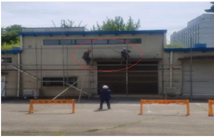
쌍줄비계 조립 작업 시 떨어짐 위험
