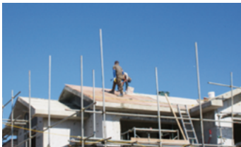
지붕작업 추락방지조치 미설치
