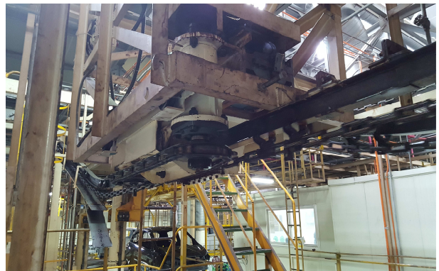
트롤리 컨베이어 구동장치
