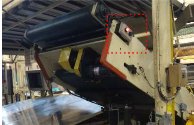
기복컨베이어 옆면에 설치된 시스템 기동 및 정지 스위치
