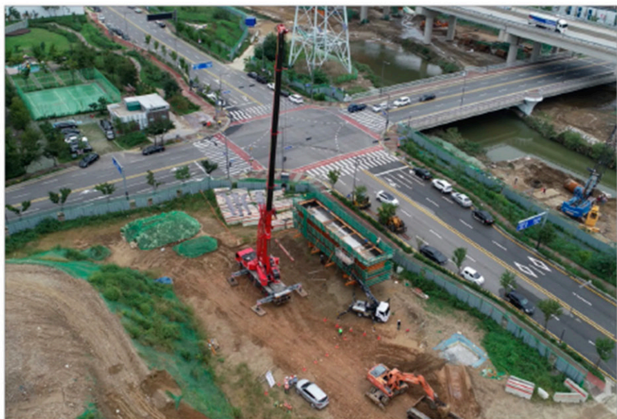
04 고속도로 교량 작업 현장. 추락사고가 발생하기 쉽다.
